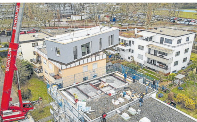
Auch komplett vorgefertigte Module in Holz-Fertigbauweise lassen sich für Neu- oder Erweiterungsbauten einsetzen.
